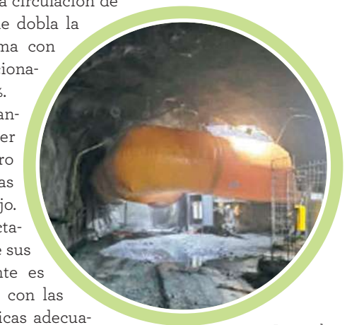
C. Ducto de ventilación que lleva el aire al frente de trabajo del túnel Guillermo Gaviria Echeverri.
