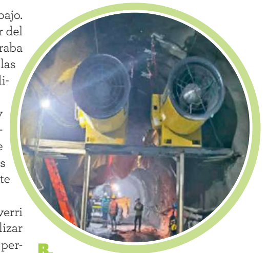
B. Ventiladores ubicados en la penúltima conexión del túnel y la galería de rescate.
