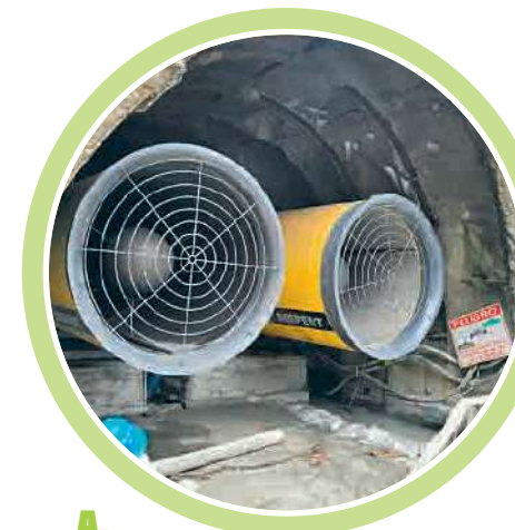
A. Ventiladores en la entrada de la galería de rescate.
